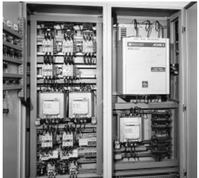
Arrancadores ralentizadores y variador
