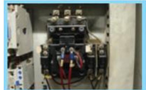
Detección de conexiones eléctricas defectuosas por termografía infrarroja
